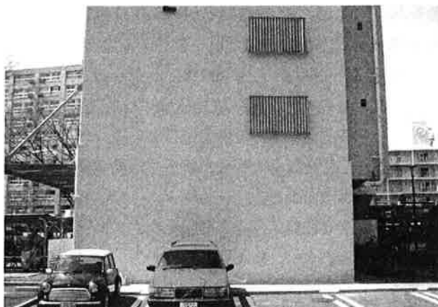
②改修後の状況(部分補修の跡もなくなり美しい仕上がりとなっている)
